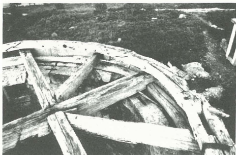
1 — Parte superior de um moinho de vento arruinado, vendo-se componentes pertencentes ao tipo de tracção por meio de grade e ao tipo de rotação por meio de sarilho interior, o que evidencia uma modificação das suas características técnicas.
