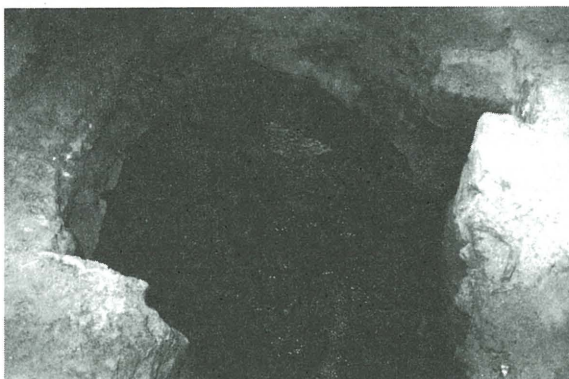
2 — Estado de ruína de uma das câmaras de rodízios de um moinho de maré, cuja manutenção irá possibilitar a observação do interior dessa componente.
